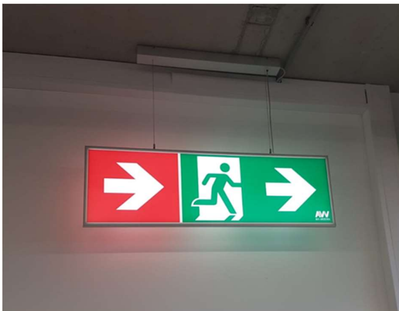
Indicação de saída e dos meios de combate a incêndios
