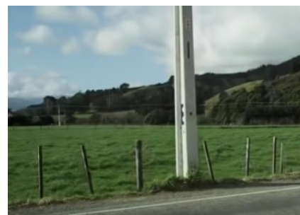
Poste junto à estrada
