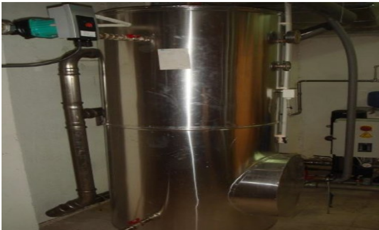
Foto 13 – Zona Técnica AQS
