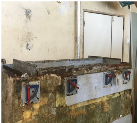
Fotos 32 – Zona Técnica Vista: Conduto ar Local: Bl. Centrais
