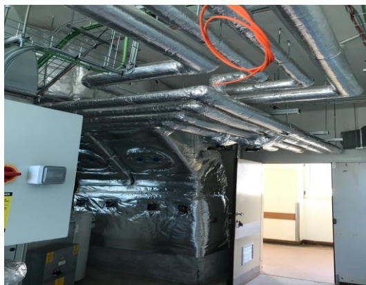
Foto 34 – Zona Técnica Vista: Tratamento de ar Local: Bl. Centrais
