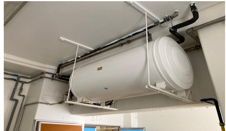
Foto 14 – Zona Técnica AQS
