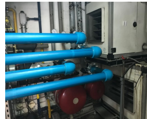
Foto 30 – Ligação Zona Técnica interior
