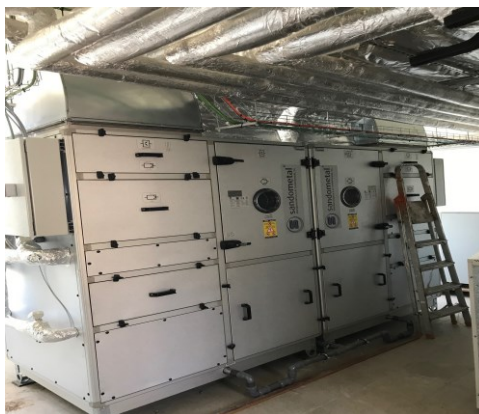
Fotos 35 – Zona Técnica Vista: Tratamento de ar Local: Bl. Centrais
