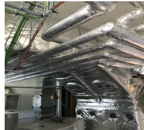
Fotos 36 – Zona Técnica Vista: Conduto ar Local: Bl. Centrais
