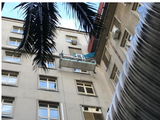
Foto 28 – Ligação Zona Técnica interior
