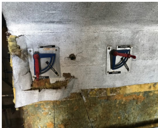
Foto 31 – Zona Técnica Vista: Tratamento de Ar Local: Bl. Centrais
