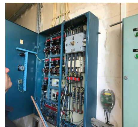
Fotos 33 – Zona Técnica Vista: Quadro Elect. Local: Bl. Centrais
