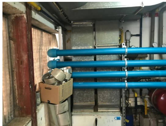
Foto 29 – Ligação Zona Técnica interior
