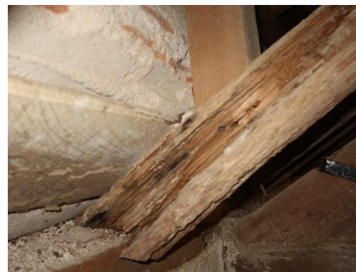
Rotura na zona de apoio
