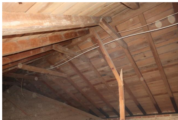
Rotura de elemento estrutural
